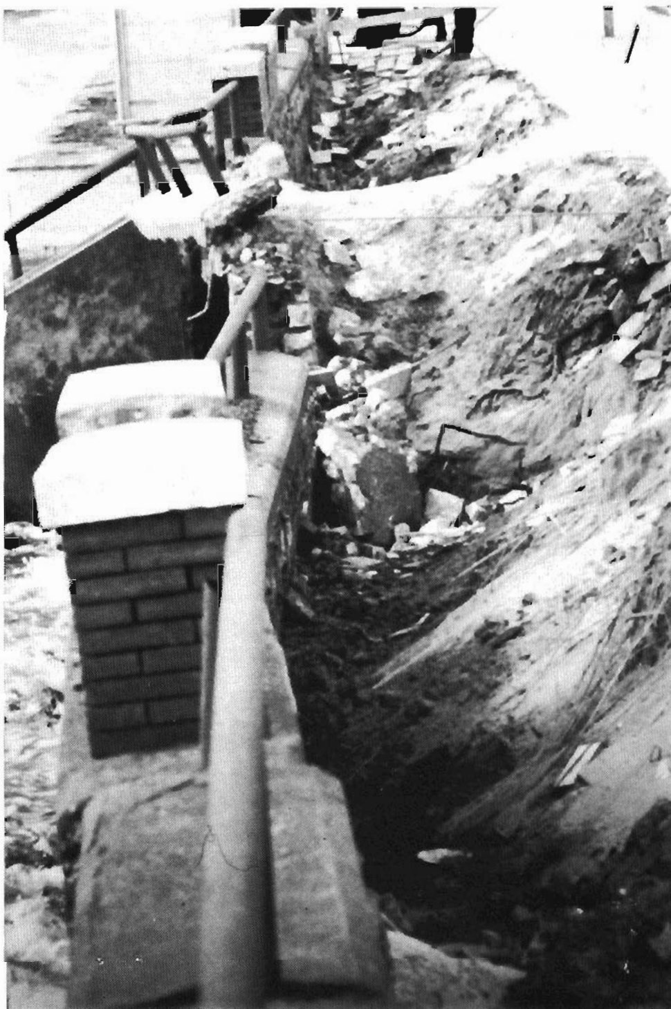
1973-1974: L'intero lungomare è investito dall'opera demolitrice del mare. Crolla il muro della passeggiata che sarà sostituito con fondazione profonda alla bentonite.
